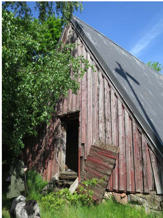
Figur 31. Foto över krutkappellets södra gavel gavel, mot nordväst. Panelen är i dåligt skick men av allt att döma är den av ganska sen datering. Foto Anette Lindgren
